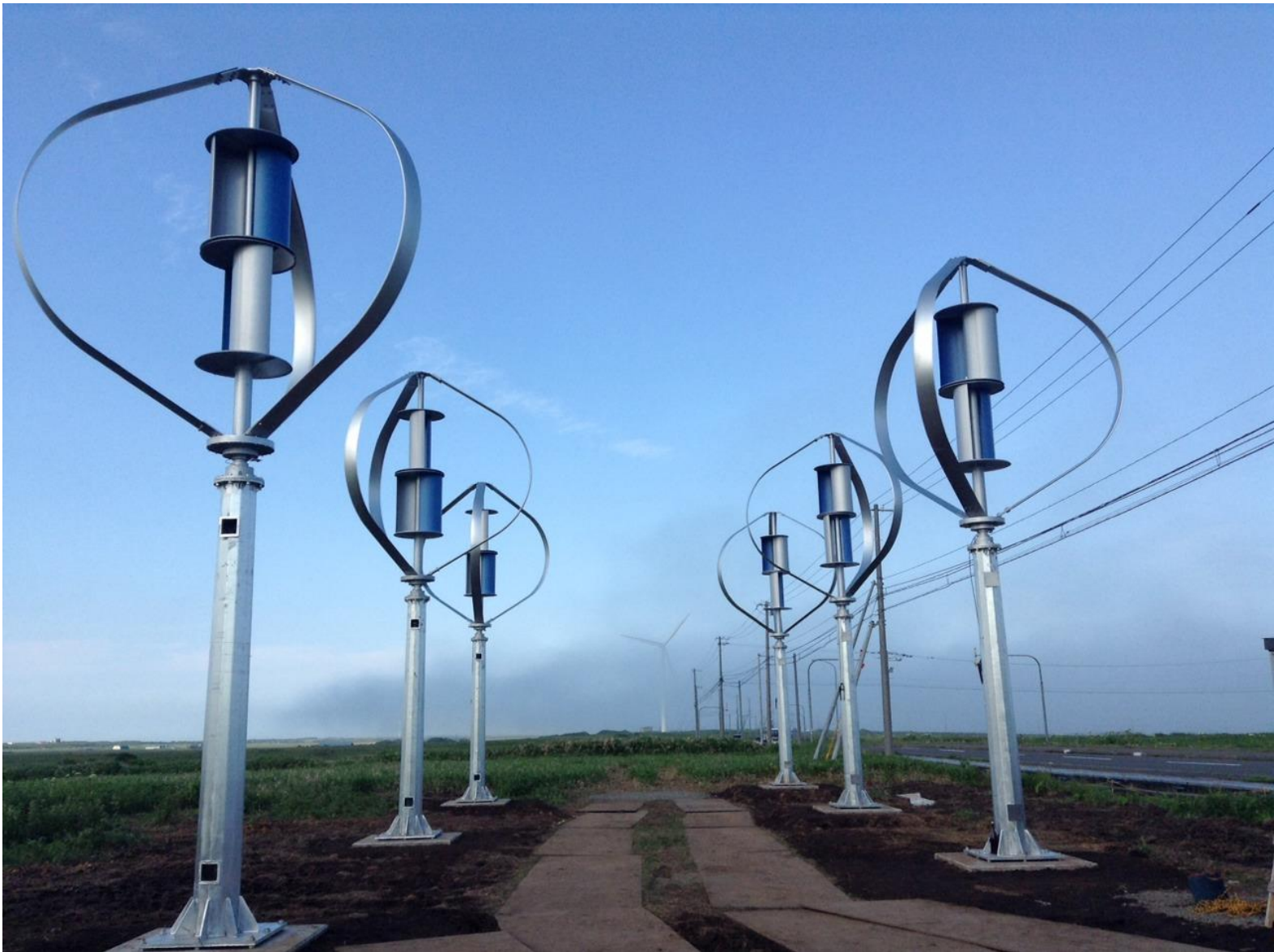
DS3000 mini wind farm grid connected
